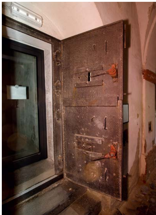
Einschüsse auf der Innenseite der Schutzraumtür.
